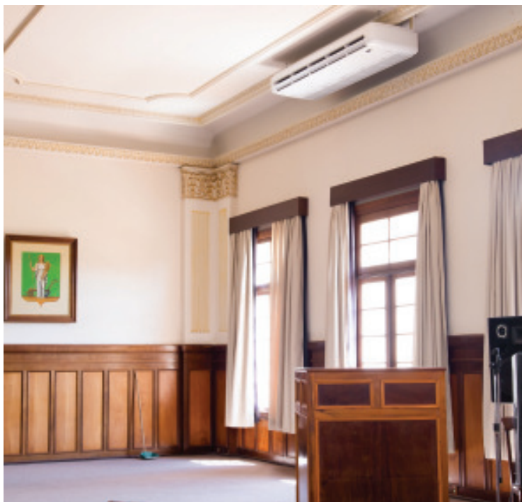
Sistema de condicionamento de ar no Salão Nobre
