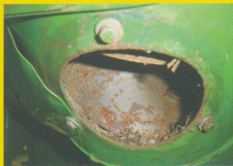
O desgaste da tinta expõe as peças à oxidação
